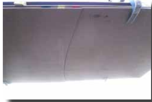
Üç noktalı kaldırma sonucunda oluşan bir çatlak örneği.
