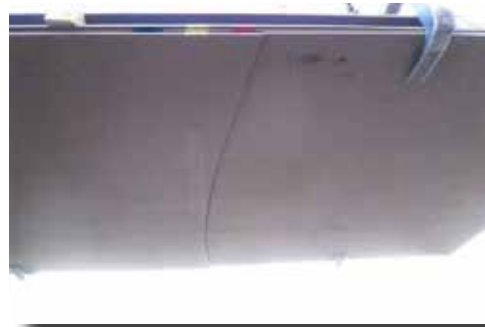
Příklad tříbodového zvedání s následnou prasklinou.
